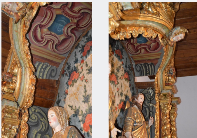
Fig. 12 a), b): No teto do nicho são visíveis algumas tábuas não decoradas aplicadas em intervenções anteriores. DETALHE, Conservação e Restauro de Mobiliário ©
