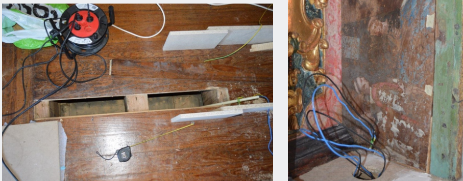
Fig. 62 a), b): Instalação elétrica para incorporar o foco LED no estrado. O foco ficou dirigido para a pintura existente do lado esquerdo da mesa de altar. DETALHE, Conservação e Restauro de Mobiliário ©
