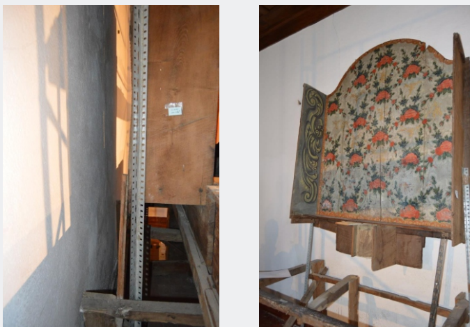
Fig. 16 a), b): Aplicação de perfis temporários no nicho. DETALHE, Conservação e Restauro de Mobiliário ©
