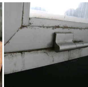
05 - SUJIDADE E OXIDAÇÃO NO ALUMÍNIO
