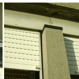
03 - HUMIDADE NA CAIXA DE ESTORE
