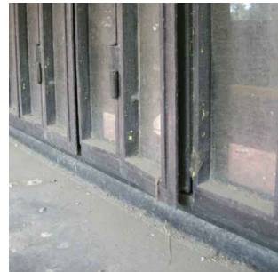
01 - SUJIDADE/DESTACAMENTO DE TINTA CAIXILHA
