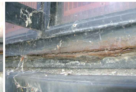
03 - SUJIDADE E DESTACAMENTO DE TINTA NA SOLEIRA [EXTERIOR]
