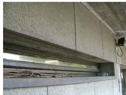
01/02/03 - SUJIDADE E DESTACAMENTO DE TINTA DA SOLEIRA
