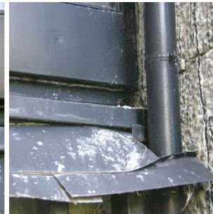
03 - DETERIOÇÃO DA RUFAGEM
