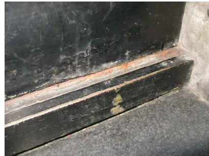
01 - CORROSÃO E DESTACAMENTO DE TINTA
