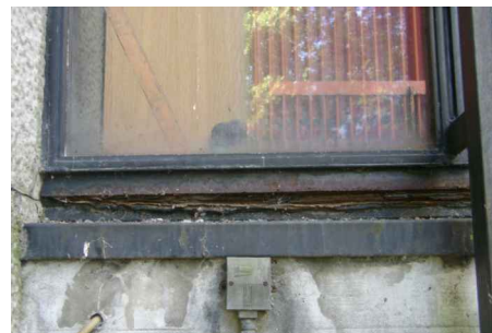
01/02 - CORROSÃO DOS ELEMENTOS METÁLICOS INFERIORES
