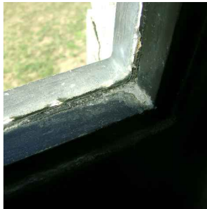
02 - SUJIDADE E DESTACAMENTO DO BETUME
