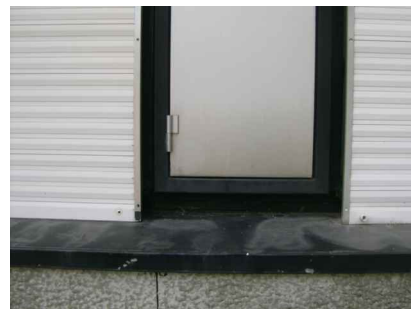
01/02 - SUJIDADE E OXIDAÇÃO DA FOLHA DE ALUMÍNIO
