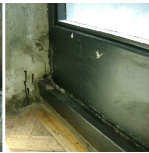
03 - DESTACAMENTO DE TINTA
