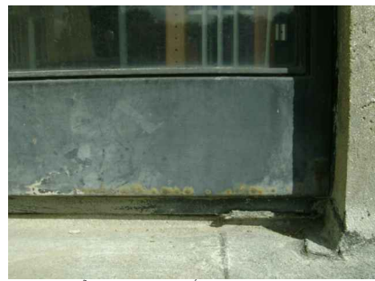
01/02 - CORROSÃO DOS ELEMENTOS METÁLICOS
