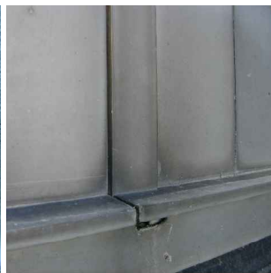
02- SUJIDADE E OXIDAÇÃO NO ALUMÍNIO
