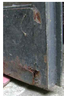
01/02 - CORROÇÃO ELEMENTOS METÁLICOS
