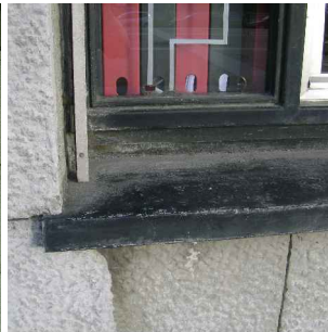
02/03 - DESTACAMENTO DE TINTA/SUJIDADE
