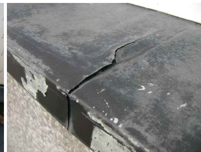
03 - FISSURAÇÃO E DESTACAMENTO DE TINTA DA SOLERA
