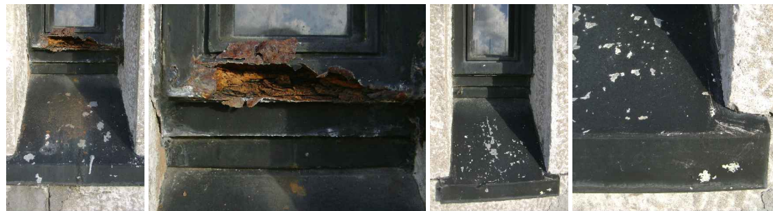
01/02 - CORROSÃO ELEMENTOS METÁLICOS INFERIORES
