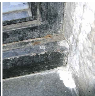
03 - CORROSÃO ELEMENTOS METÁLICOS INFERIORES
