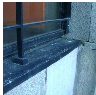
01-DESTACAMENTO DE TINTA NA SOLEIRA
