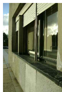
01/02/03 - SUJIDADE/DESTACAMENTO DE TINTA CAIXILHO
