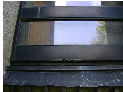
01/02 - CORROÇÃO ELEMENTOS METÁLICOS INFERIORES
